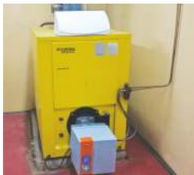
Zdj. 32. Stary kocioł olejowy w jednym z budynków pilotażowych (fot. Jerzy Tymczyszyn, Urząd Gminy w Raciechowicach)
