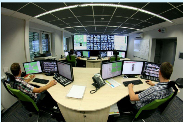
Centrum Sterowania Ruchem przy ul. Płowieckiej.
