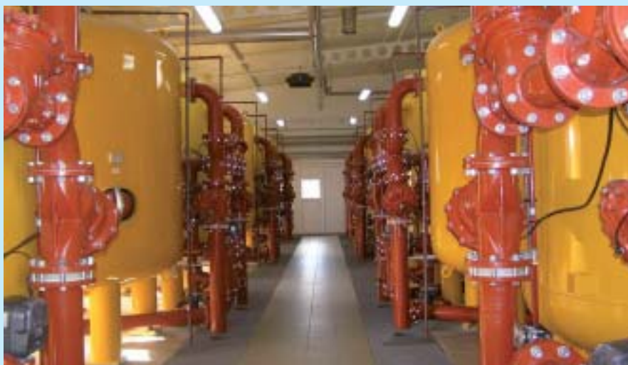
Stacja Uzdatniania Wody w Elblągu (filtry).
